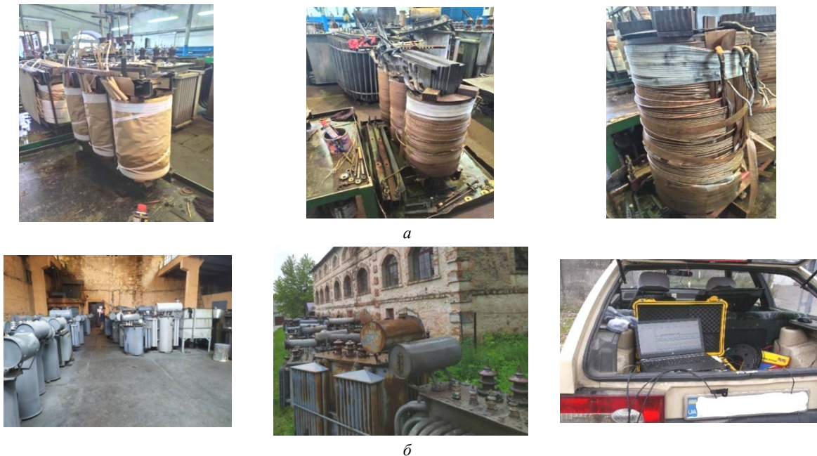
Рис. 2. На дільниці з ремонту СТ АТ «Вінницяобленерго»: a — пошкоджені силові трансформатори 10 кВ під час ремонту; b — відремонтовані силові трансформатори 10 кВ та діагностичне обладнання
