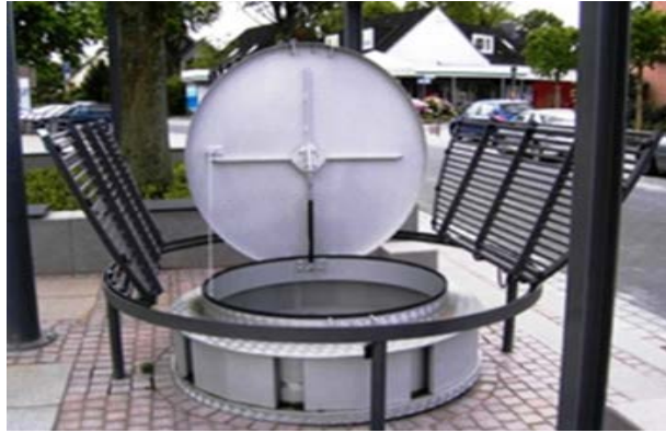
Рис. 4. Зовнішній вигляд трансформаторної станції французької компанії ORMAZABAL
