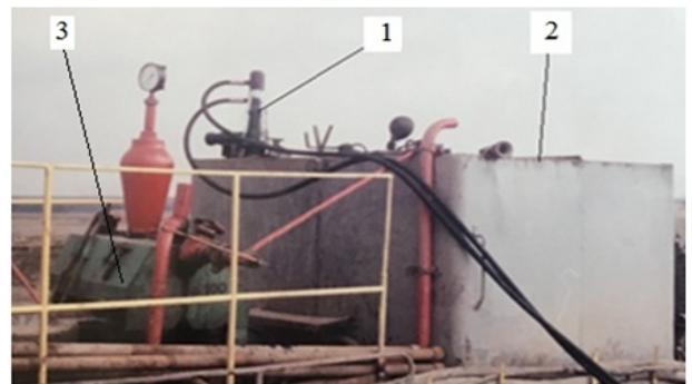
Рис. 7. Установа дослідного зразка ПІ над баком робочої рідини насосного агрегата ЦА-320: 1 — адаптивний генератор імпульсів; 2 — бак; 3 — насос
