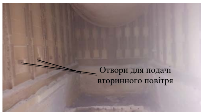
Рис. 1. Внутрішня будова топки котла, що працює на трісці деревини
